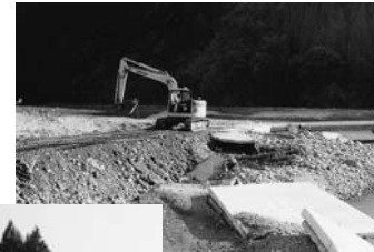
台風の被害を受けた小切畑潜水橋
