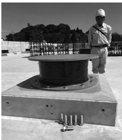
実際に設置した免震装置
