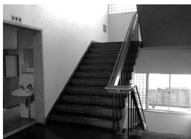
片側にだけしか手すりのない役場階段
