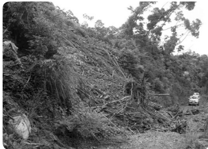
入谷線法面崩壊(予備費)
