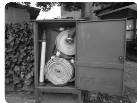
消火栓ボックス
