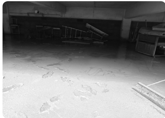
西門川小中体育器具破損・汚泥蓄積(予備費)
