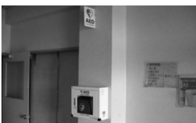
中央公民館に設置されたAED
