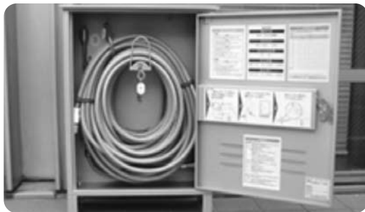
まちかど消火栓
