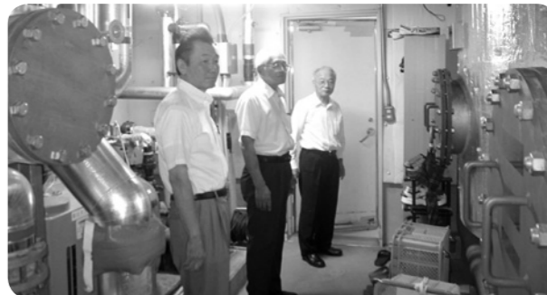
心の杜視察 ハレットボイラー
