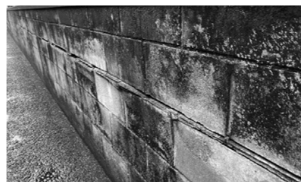
亀裂の入ったブロック塀
