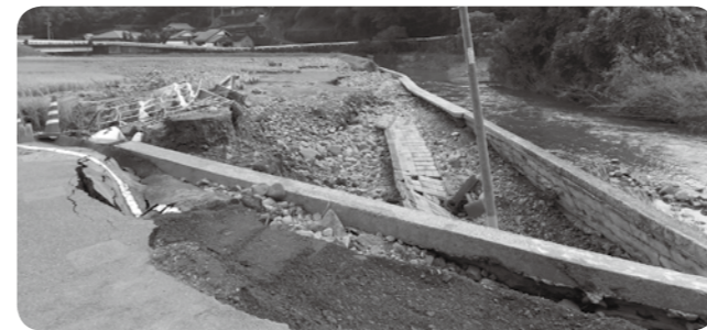
大原地区被災状況
