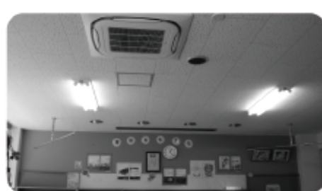
平成26年度寄付金により27年度に全小中学校エアコン設置
