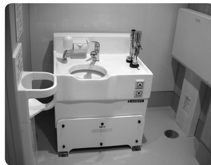
オストメイト対応多機能トイレ(中央公民館)
