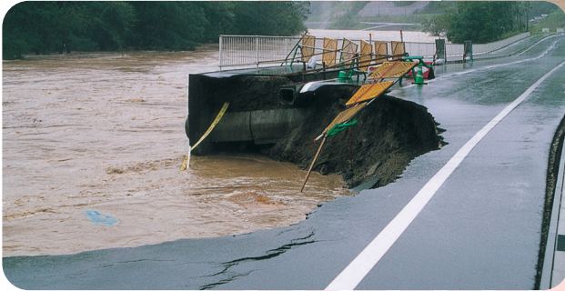
大きな被害を受けた国道388号線（門川・北郷間）
