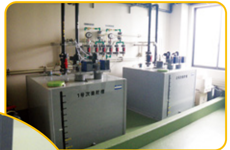
① 薬品注入室 やくひんちゅうじゅうしつ
