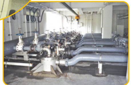
① 送水ポンプ
