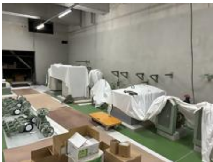
し尿処理に必要な機器を地下階に搬入し、設置を行っています
