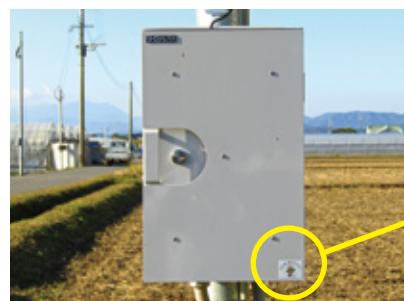
音声増幅制御盤
