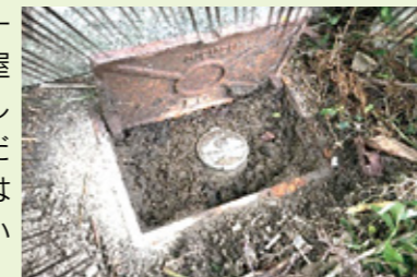
土に埋もれているメーター
