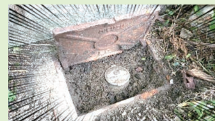
土に埋もれているメーター
