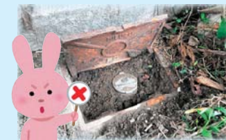
土に埋もれたメーター
