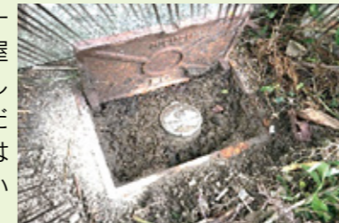
土に埋もれているメーター
