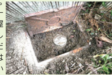
土に埋もれているメーター
