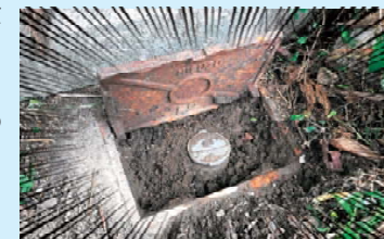
土に埋もれているメーター
