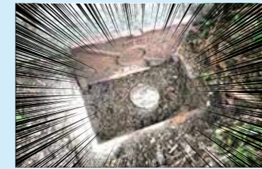
土に埋もれているメーター
